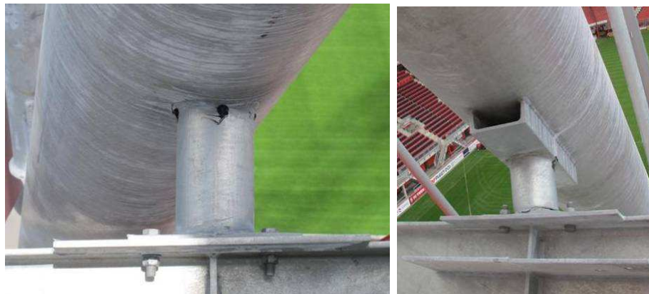
Foto 4.11: Verbinding van de gordingen met de spanten via een buisprofiel; links zonder en rechts met een U-profiel (TNO)
