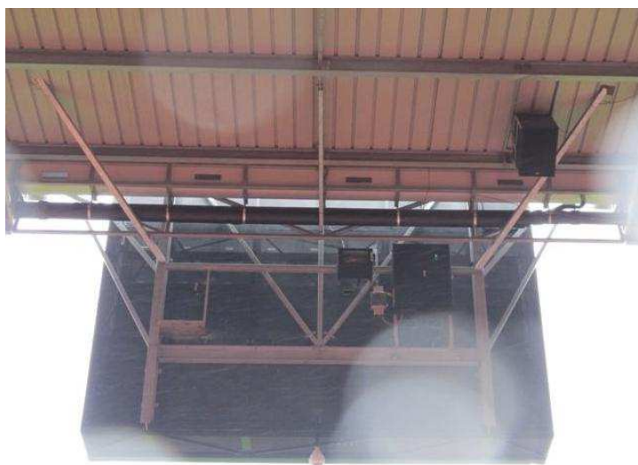
Foto 4.14: Vidi-wall met de achterliggende ophangconstructie - bestaande situatie van de L-uitbreiding (TNO)
