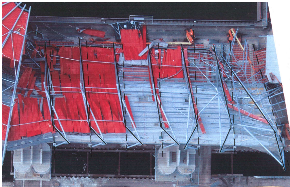
Foto 6.4: Overzicht van de omlaag gekomen spanten; de stippellijnen zijn de oorspronkelijke posities van de spanten; de getrokken lijnen de situering van de onderregel van de spanten na de instorting [F.106]
