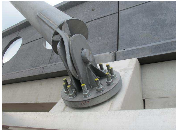
Foto 5.6: Verbindingsplaat aan uiteinde spantdeel 2-3, ter plaatse van knooppunt 3, is verbogen
