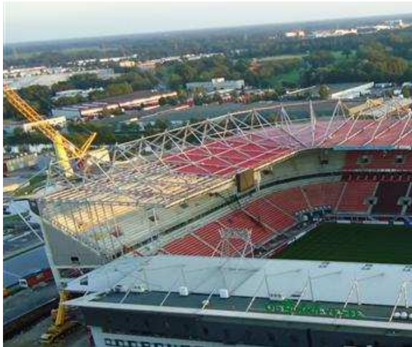
Foto 6.1: Situatie van de dakplaten op de overkapping op de avond voor de instorting [F.064]
