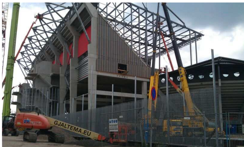
Foto 6.2: Eindwand aan spant Z1 op de dag voor de instorting, omstreeks 16.00 uur [F.076]
