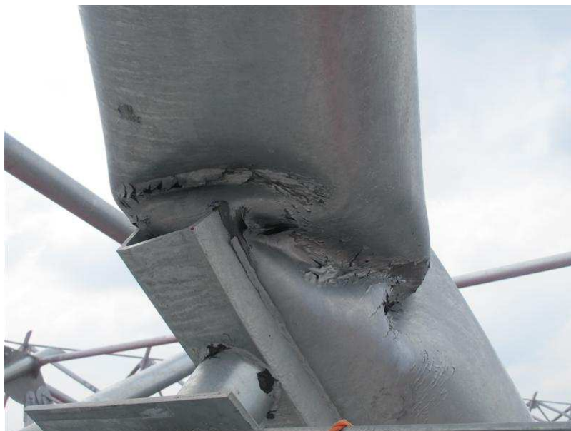
Foto 6.35: Spant 10 met het weggebogen deel tussen de knooppunten 2 en 5 (TNO)
