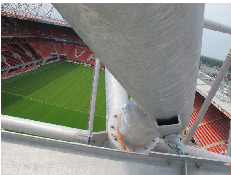
Foto 6.42: Spant 9 met het weggebogen deel tussen de knooppunten 2 en 5 (TNO)
