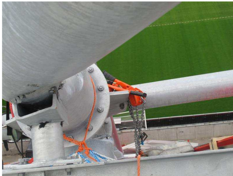
Foto 6.34: Spant 10 met het weggebogen deel tussen de knooppunten 2 en 5 (TNO)
