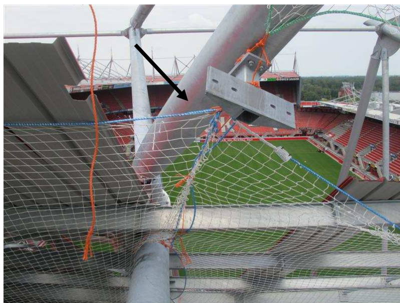
Foto 6.26: Spant 11 met het weggebogen deel tussen de knooppunten 2 en 5 (TNO)
