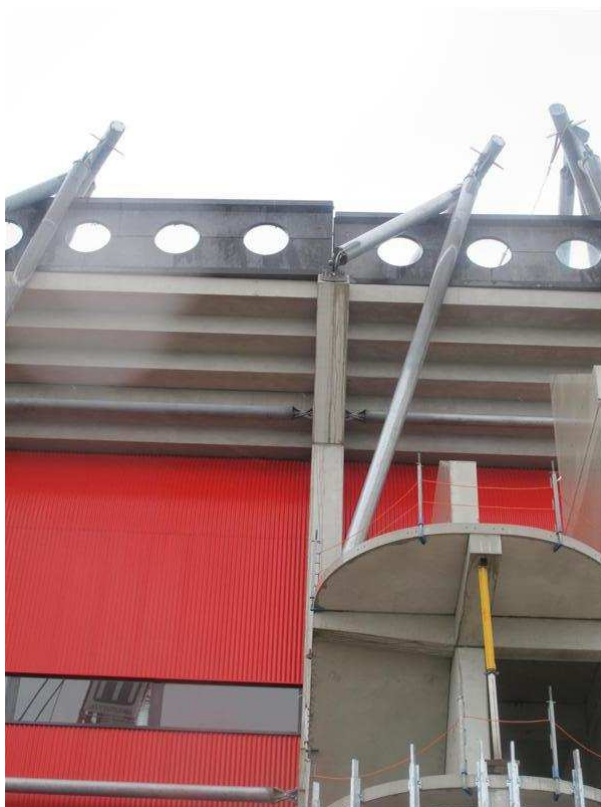
Foto 6.31: Spant 10 met het weggebogen deel aan de buitenzijde (TNO)
