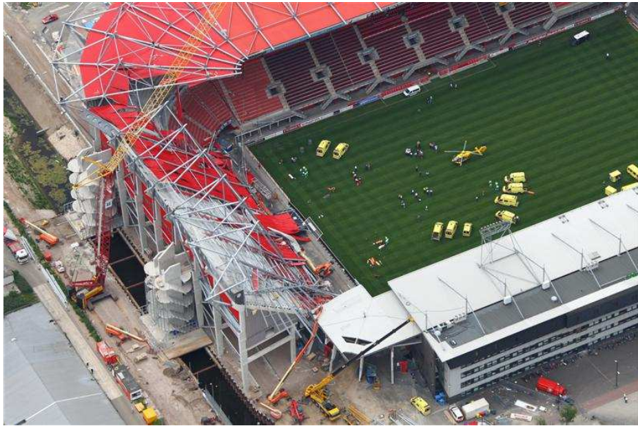
Foto 6.3: Zijaanzicht van de omlaag gekomen spanten [F.008]
