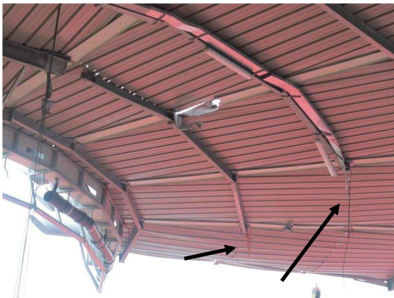
Foto 7.3: Ontbrekende gordingen in het binnenste deel van de dakconstructie (TNO)
