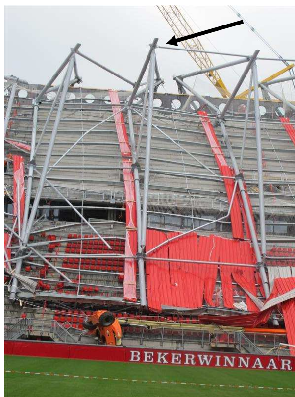
Foto 6.38: Spant 9 na de instorting (TNO)
