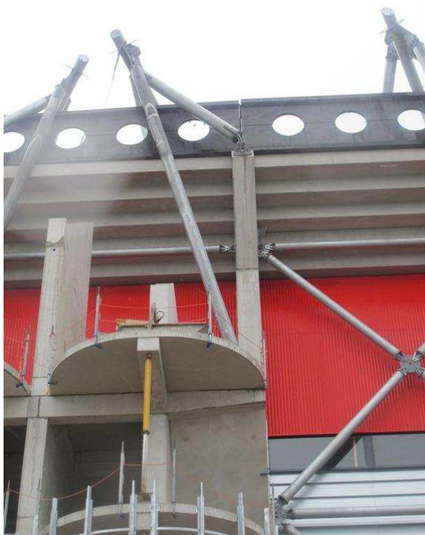
Foto 6.39: Spant 9 met het weggebogen deel aan de buitenzijde (TNO)
