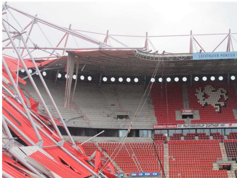
Foto 6.8: Spant Z17 tot en met spant Z20 niet bezweken – aanzicht aan binnenzijde (TNO)
