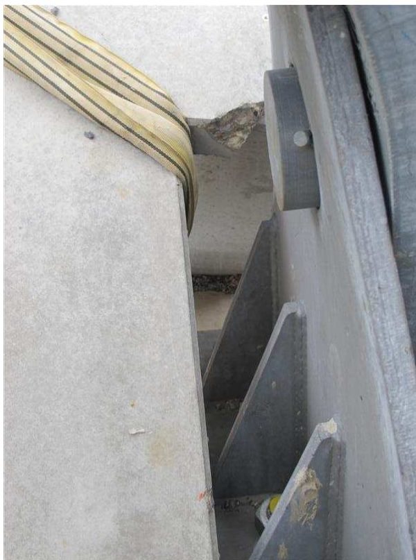
Foto 8.9: Strop ter plaatse van knooppunt 4 van spant Z1 (TNO)
