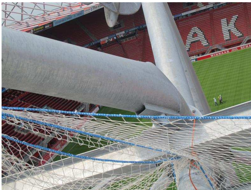
Foto 6.41: Spant 9 met het weggebogen deel tussen de knooppunten 2 en 5 (TNO)
