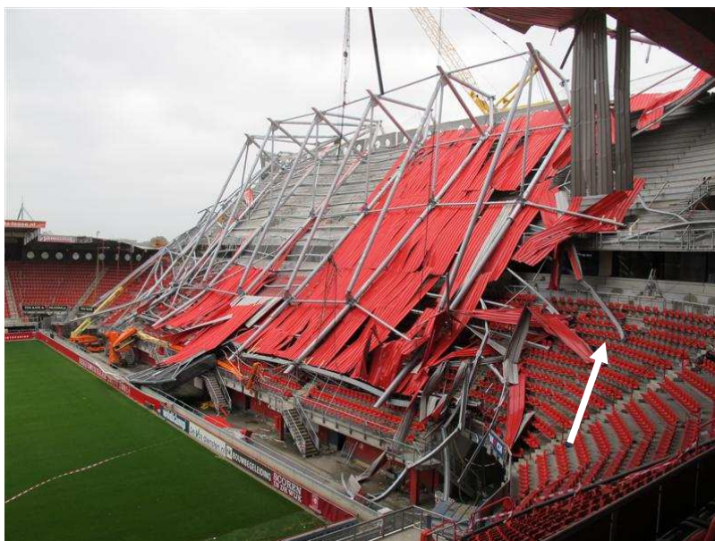
Foto 7.9: Gordingen tussen de spanten 13 en Z20 omlaag gevallen, met uitzondering van de buitenste gordingen (TNO)
