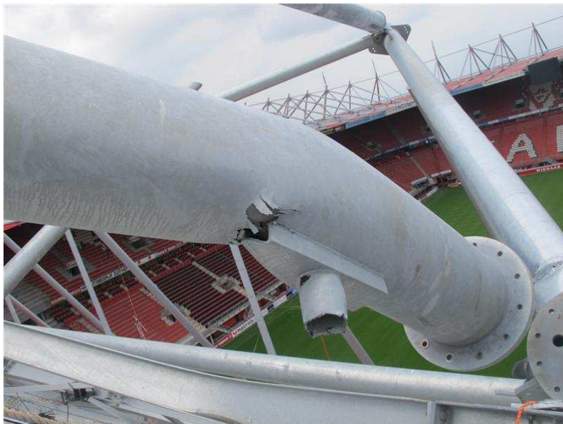
Foto 6.47: Spant 8 met het weggebogen deel tussen de knooppunten 2 en 5 (TNO)
