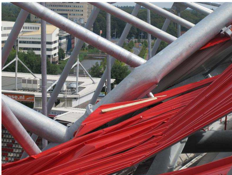
Foto 6.13: Spant 13 met het weggebogen deel tussen de knooppunten 2 en 5 (TNO)
