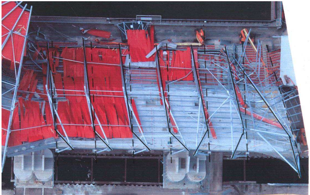
Foto 6.4: Overzicht van de omlaag gekomen spanten; de stippellijnen zijn de oorspronkelijke posities van de spanten; de getrokken lijnen de situering van het horizontale deel van de spanten na de instorting [F.106]
