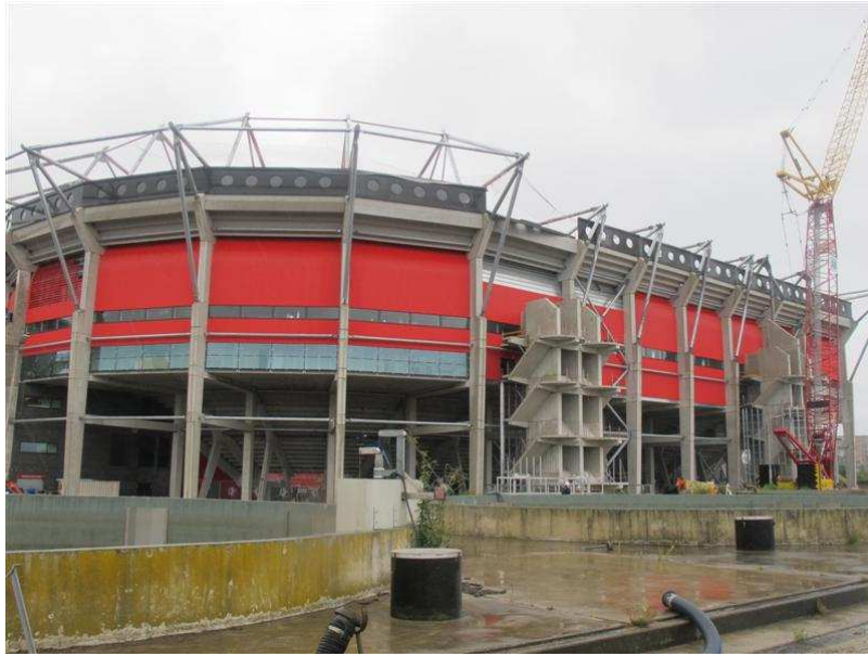
Foto 6.9: Spant Z17 tot en met spant Z20 niet bezweken – aanzicht aan buitenzijde (TNO)
