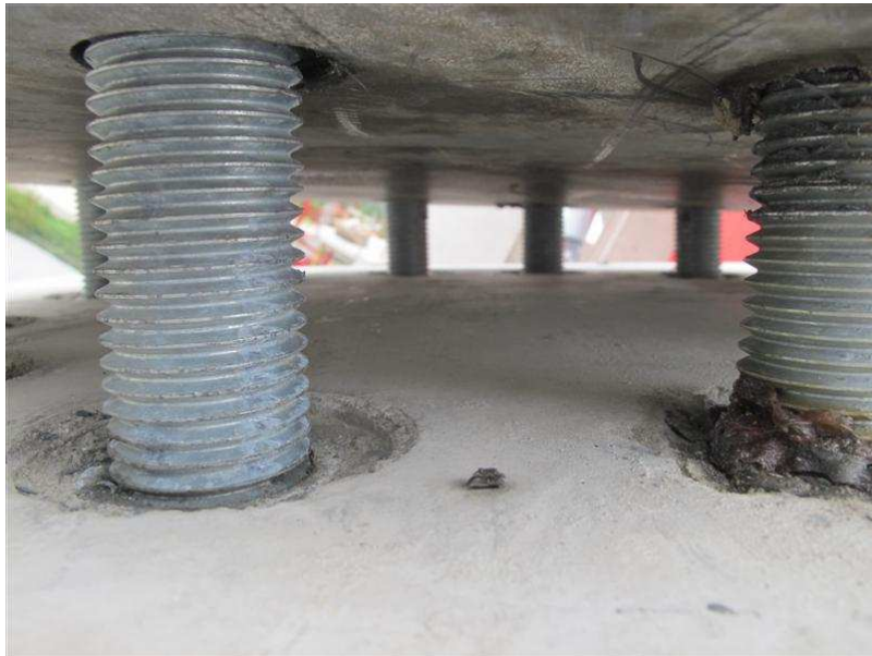
Foto 8.5: Knooppunt 1 van spant Z1 – geen schade aan beton rond ankers (TNO)
