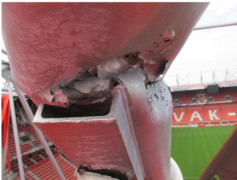
Foto 6.21: Spant 12 met het weggebogen deel tussen de knooppunten 2 en 5 (TNO)
