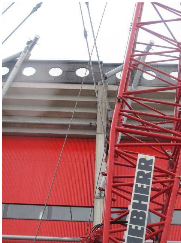
Foto 6.25: Spant 11 met het weggebogen deel aan de buitenzijde (TNO)
