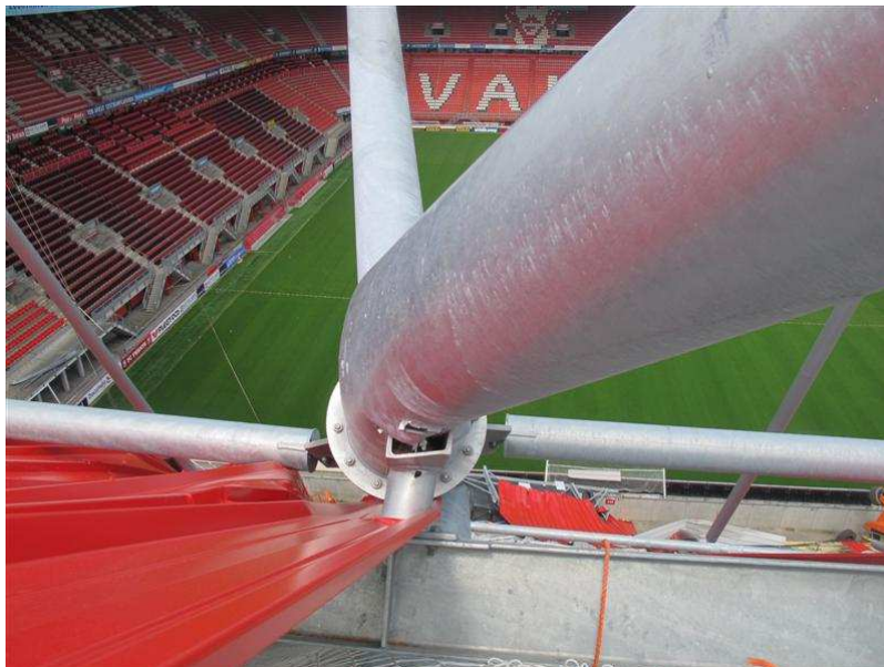
Foto 6.27: Spant 11 met het weggebogen deel tussen de knooppunten 2 en 5 (TNO)
