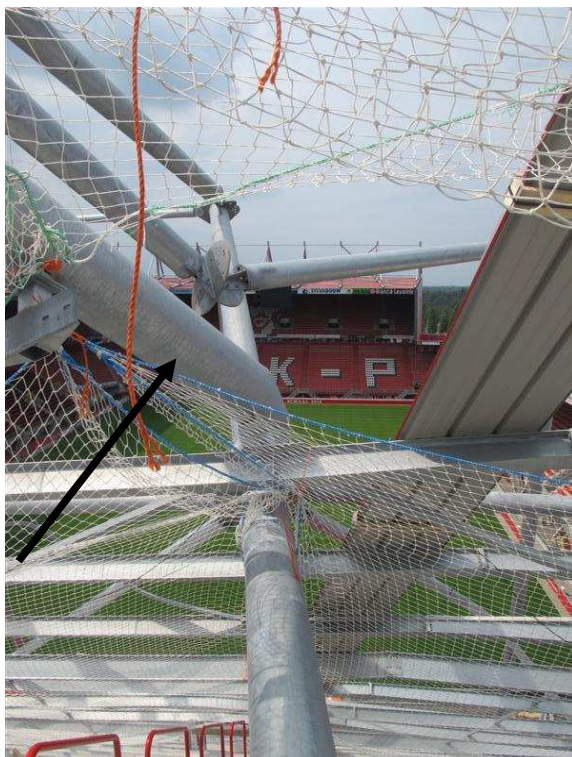
Foto 6.40: Spant 9 met het weggebogen deel tussen de knooppunten 2 en 5 (TNO)
