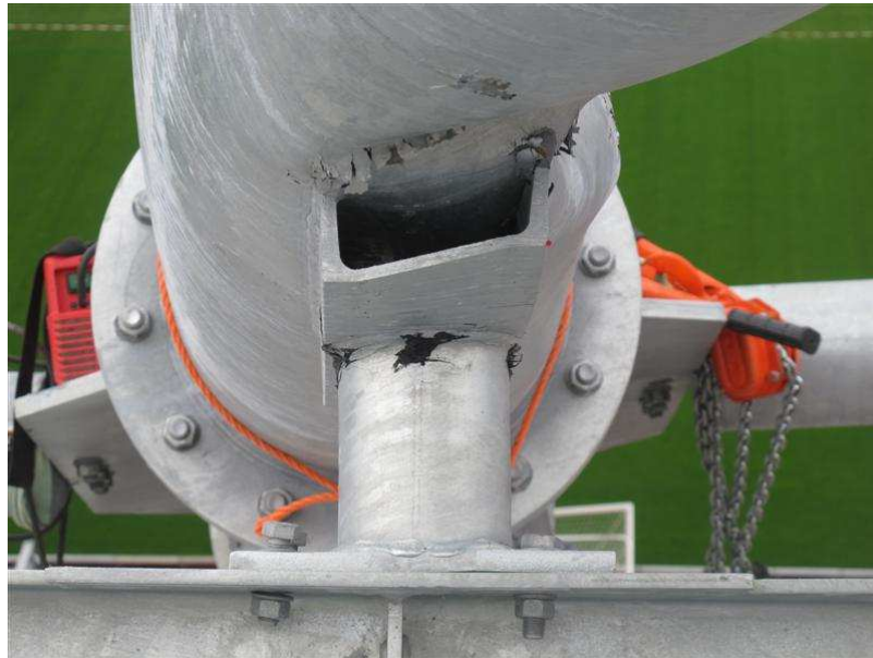
Foto 6.33: Spant 10 met het weggebogen deel tussen de knooppunten 2 en 5 (TNO)
