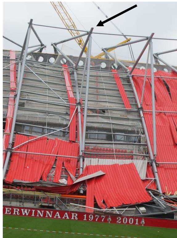
Foto 6.30: Spant 10 na de instorting (TNO)
