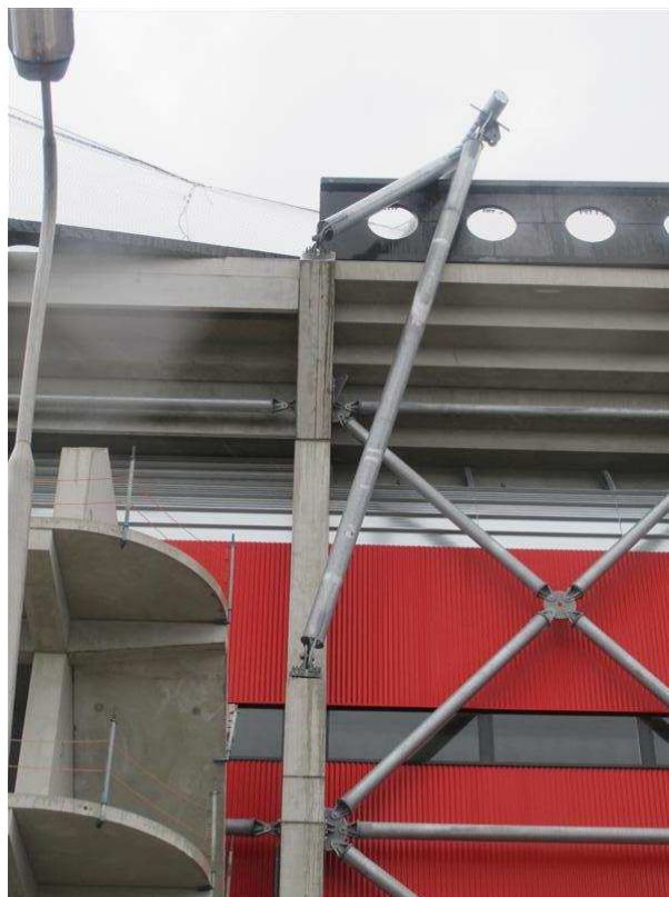
Foto 6.11: Spant 13 met het weggebogen deel aan de buitenzijde (TNO)
