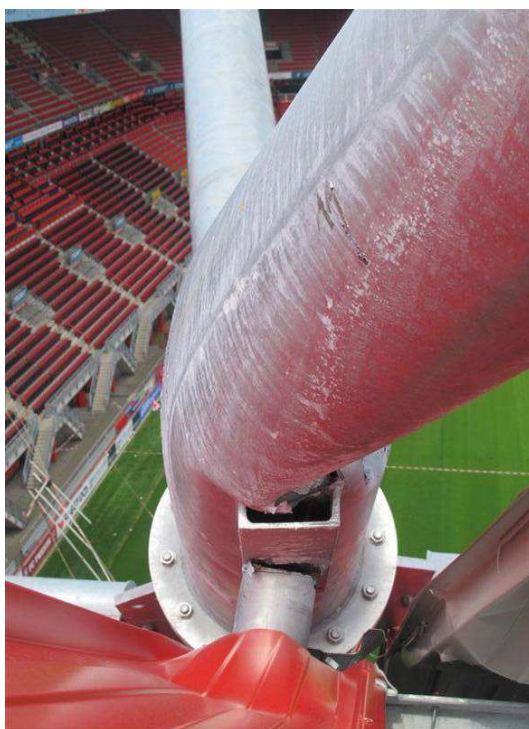
Foto 6.20: Spant 12 met het weggebogen deel tussen de knooppunten 2 en 5 (TNO)
