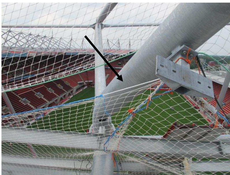
Foto 6.32: Spant 10 met het weggebogen deel tussen de knooppunten 2 en 5 (TNO)
