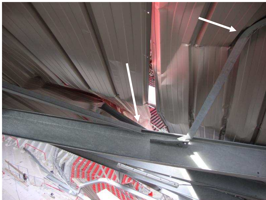
Foto 7.16: Stabiliteitsverband losgetrokken (links) en uitgeknikt (rechts) (TNO)
