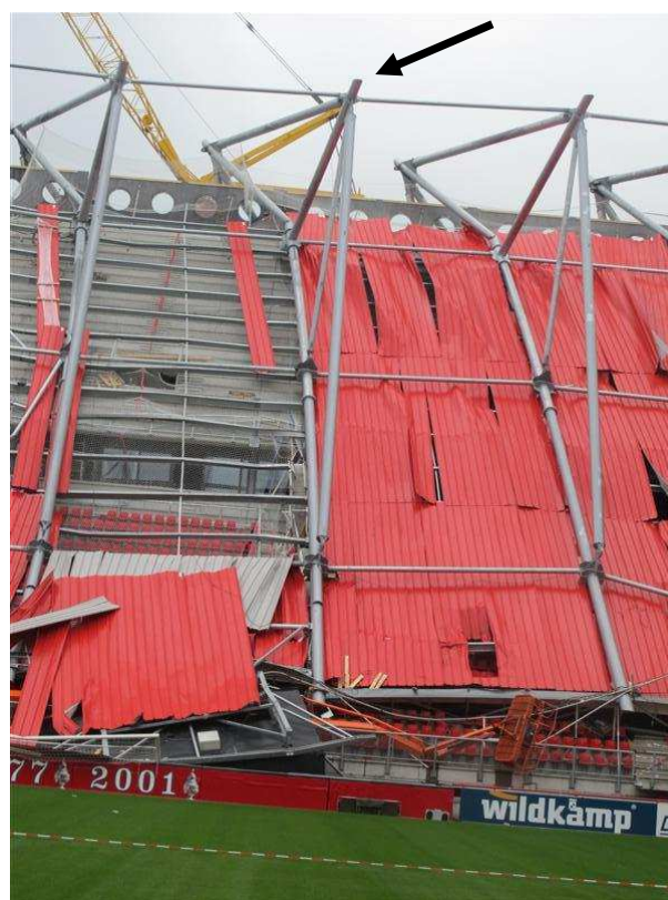
Foto 6.24: Spant 11 na de instorting (TNO)
