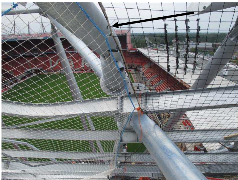
Foto 6.46: Spant 8 met het weggebogen deel tussen de knooppunten 2 en 5 (TNO)
