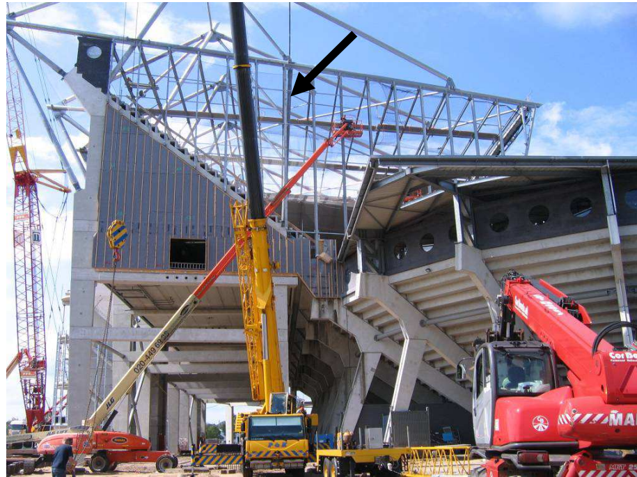
Foto 5.3: Opname ochtend voor de instorting – frame voor eindwand aan spant Z1 en kolom tussen spant en tribune (pijl) [F.033]
