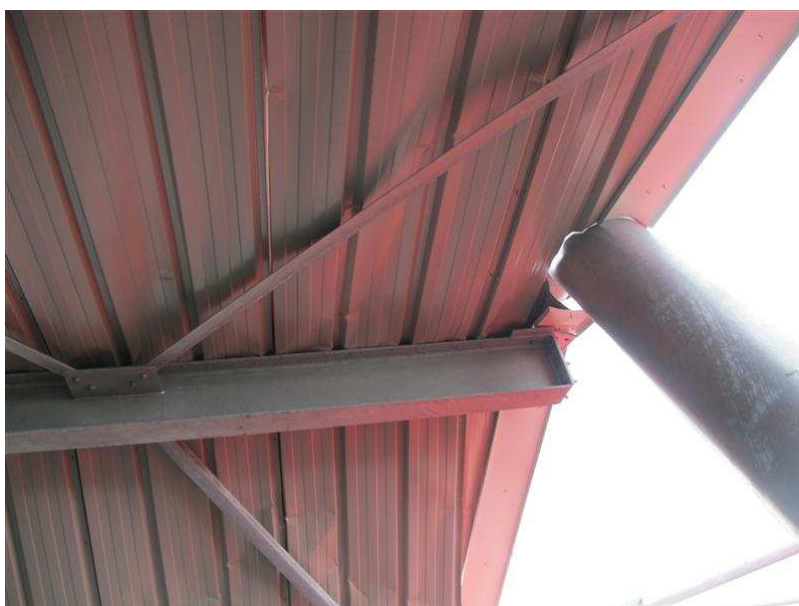
Foto 7.6: Tweede gording vanaf de buitenzijde ter plaatse van spant Z20 (TNO)
