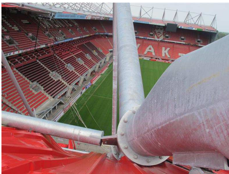
Foto 6.22: Spant 12 met het weggebogen deel tussen de knooppunten 2 en 5 (TNO)
