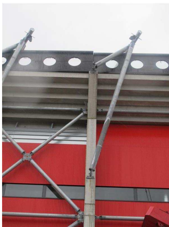
Foto 6.18: Spant 12 met het weggebogen deel aan de buitenzijde (TNO)
