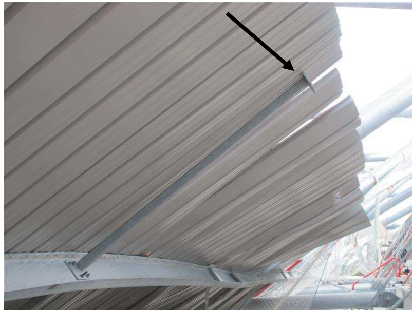
Foto 7.15: Kokerprofiel niet verbonden met wandelement (TNO)
