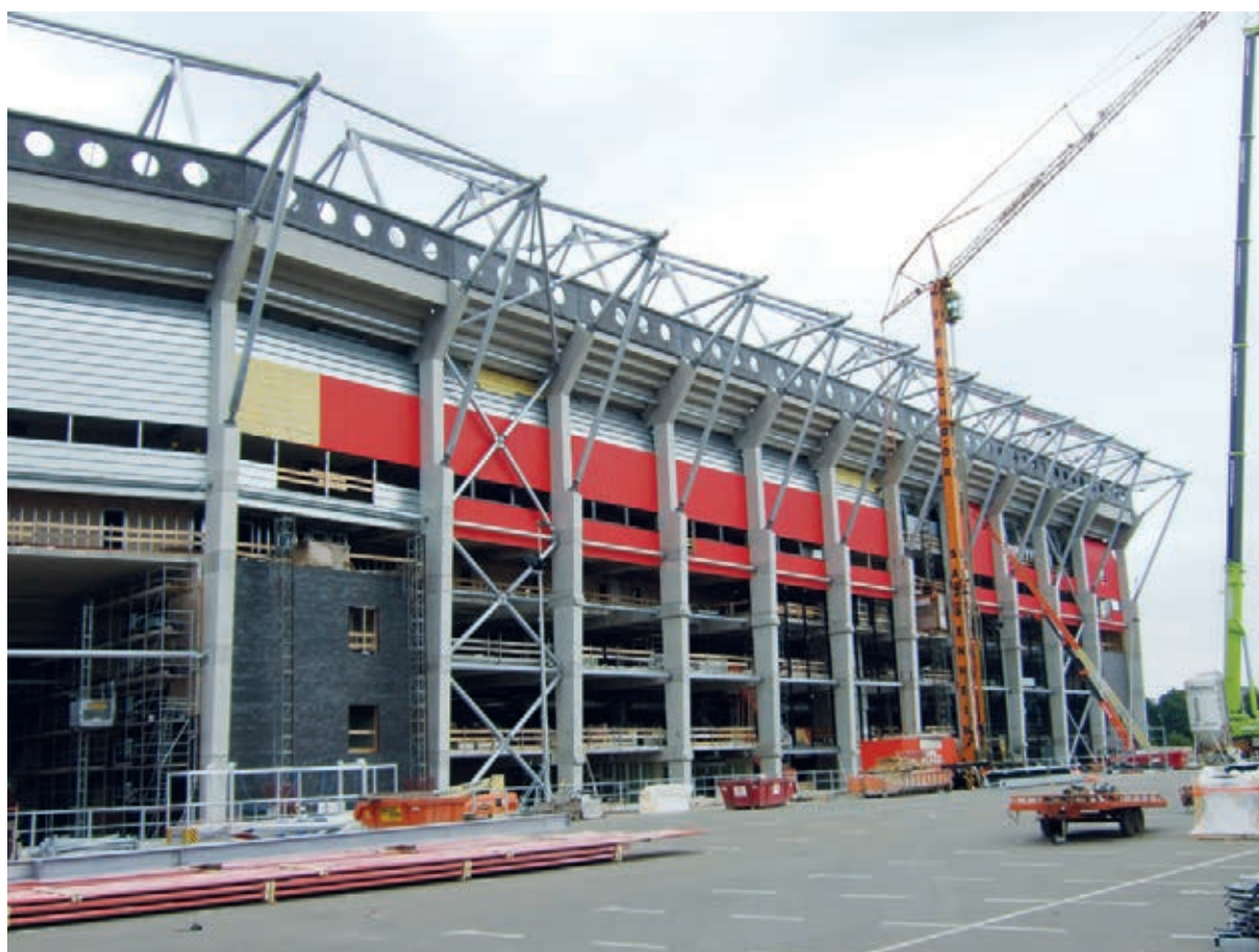
Figuur 11: L-uitbreiding: koppelbuizen ontbreken en stabiliteitsverbanden zijn aanwezig 58
