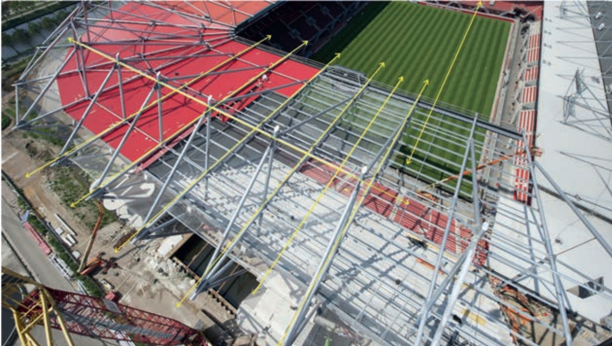
Figuur 16: Bovenaanzicht dak met kromme spanten (Bron: Politie Twente)
